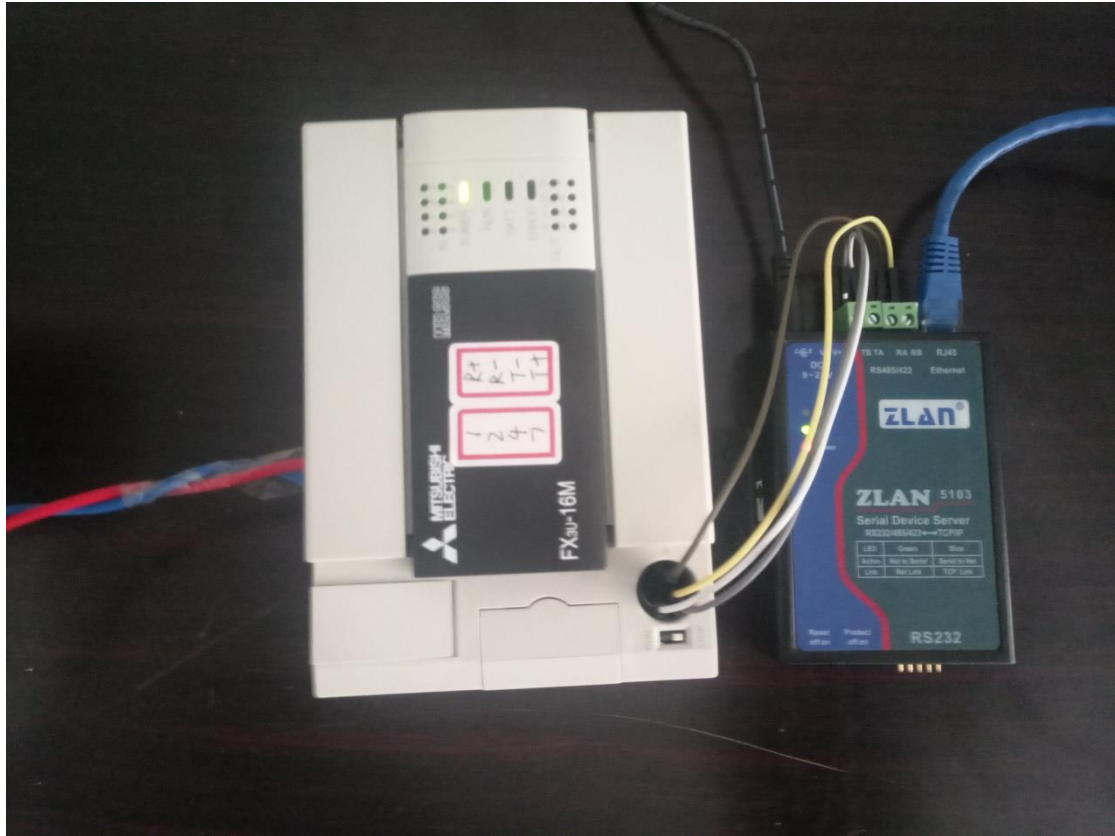
422 的 4 线直接对接 5103 (T 与 R 交叉接, 正接正负接负)
