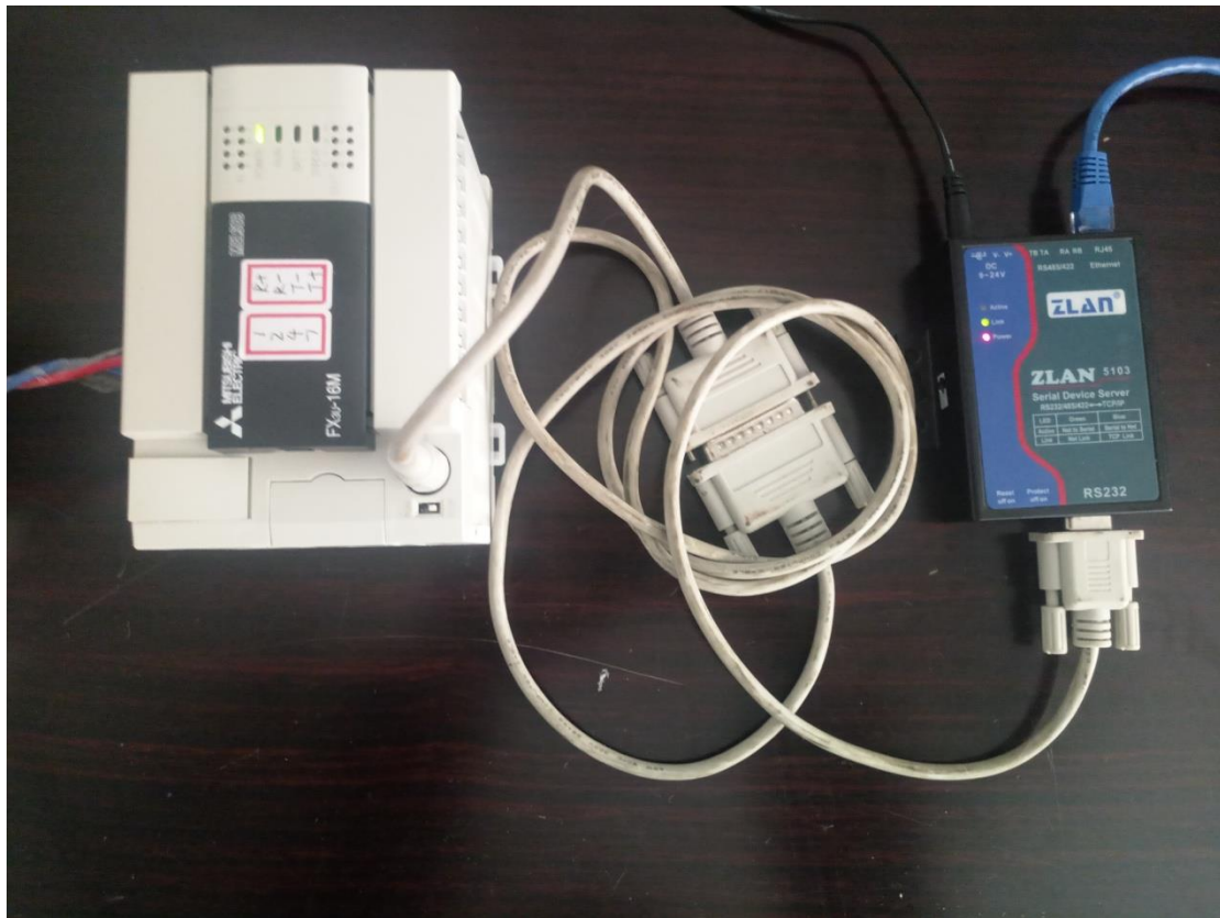
通过专用电缆线转为 232 通讯对接 5103
